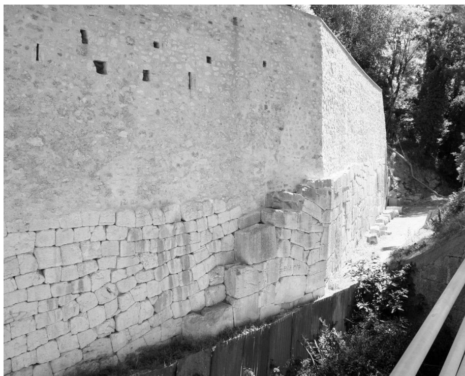
Zdjęcie wykonane 16 lipca 2008 roku, podczas pierwszych prac zabezpieczających bramę. Mur poligonalny biegnie tutaj w kierunku zachodnim aż do punktu, w którym ukośnie przechodzi w nową konstrukcję z epoki późnorzymskiej (fot. Broussard).
