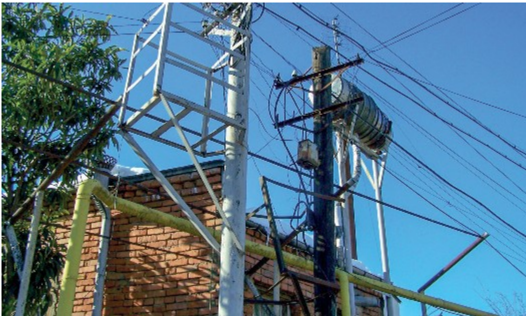
Plątanina rur, kabli, przewodów i innych patentów. Wbrew pozorom wszystko działa i miejscowi wiedzą, co i jak!
