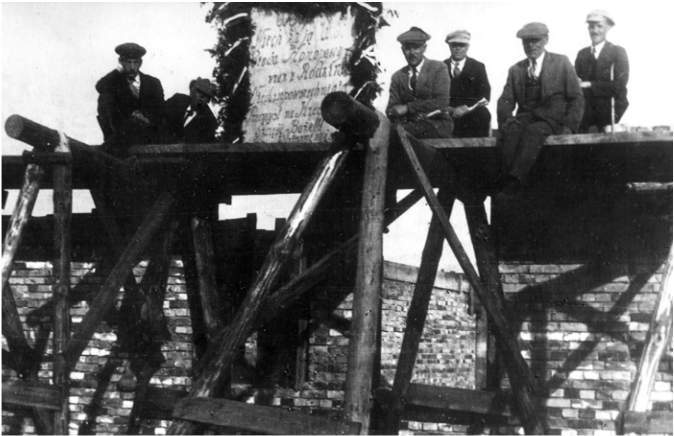
27. Uroczystość zakończenia budowy w 1926 roku. Napis na tablicy: Niech żyją W.P. Bracia Konopaccy wraz z Rodzinami. Niech upowszechnią Przemysł na Kresach. Szczęść Boże!
