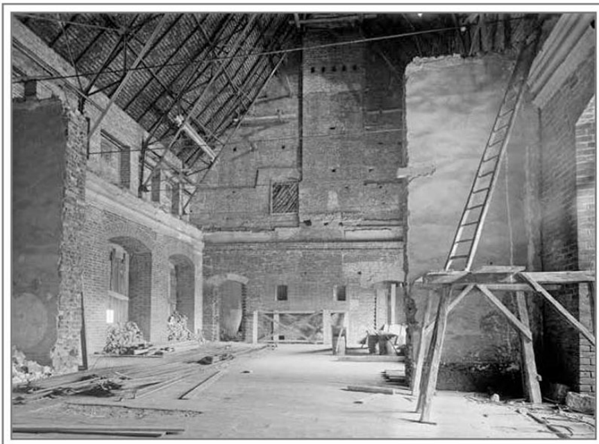
Sala Senatorska ze zdemontowanym stropem podczas prac remontowych na początku XX wieku. Powyżej imponująca przestrzeń pałacowego strychu.
