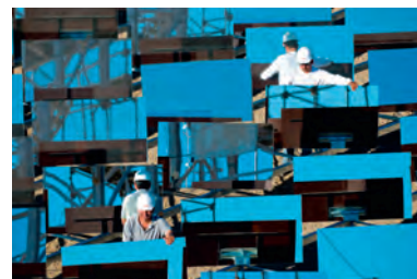
Fot. 25.12. Inżynierowie montują koncentrującą elektrownię słoneczną eSolar wyposażoną w heliostaty (lustra rotujące i przechylające się w pogoni za słońcem). www.esolar.com produkuje elektrownie średniej wielkości: jednostka o mocy szczytowej 33 MW na 64-hektarowej działce. To 51 W/m 2 przy mocy szczytowej, przypuszczam więc, że w typowej pustynnej lokalizacji te elektrownie dostarczałyby jedną czwartą tej wartości, czyli 13 W/m 2 .
