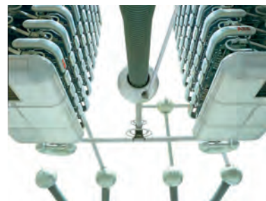
Fot. 25.13. Wysokonapięciowy układ przesyłowy prądu stałego HVDC w Chinach Fot. ABB
