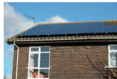
Fot. 6.5. Panele fotowoltaiczne. Dane pochodzą z roku 2006 dla systemu o powierzchni 25 m 2 , znajdującego się w Cambridgeshire. Moc szczytowa dostarczana przez system wynosi około 4 kW. Średnia roczna moc wynosi 12 kWh dziennie, czyli 20 W na metr kwadratowy panelu.
