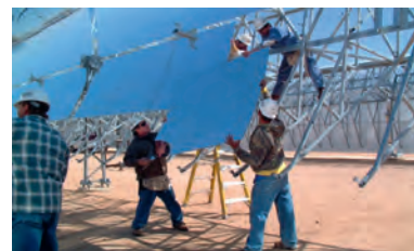
Fot. 25.4. Andasol – elektrownia słoneczna o mocy „100MW” budowana w Hiszpanii. Nadmiar energii cieplnej wyprodukowanej w ciągu dnia będzie magazynowany w zbiornikach z ciekłymi solami nawet do 7 godzin, zapewniając nieprzerwaną i stabilną podaż energii elektrycznej do sieci. Przewiduje się, że elektrownia będzie produkować 350 \text{ GWh} rocznie (40 MW). Zwierciadła paraboliczne zajmują 400 \text{ ha} , stąd też moc na jednostkę powierzchni wyniesie 10 \text{ W/m}^2 . Fot. IEA SolarPACES
