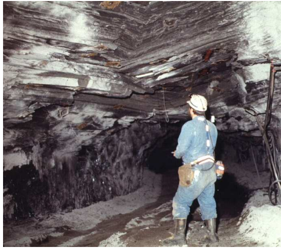
Rys. 7. Destrukcja stropu wyrobiska górniczego na skutek działania wzmożonych naprężeń poziomych [25]
