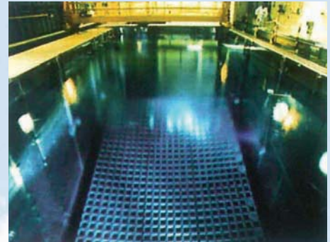
Basen do przechowywania paliwa wypalonego
