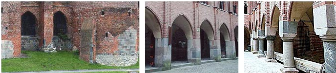
Wbrew pozorom w malborskim zamku jest sporo elementów kamiennych i to w kluczowych punktach budowy.
