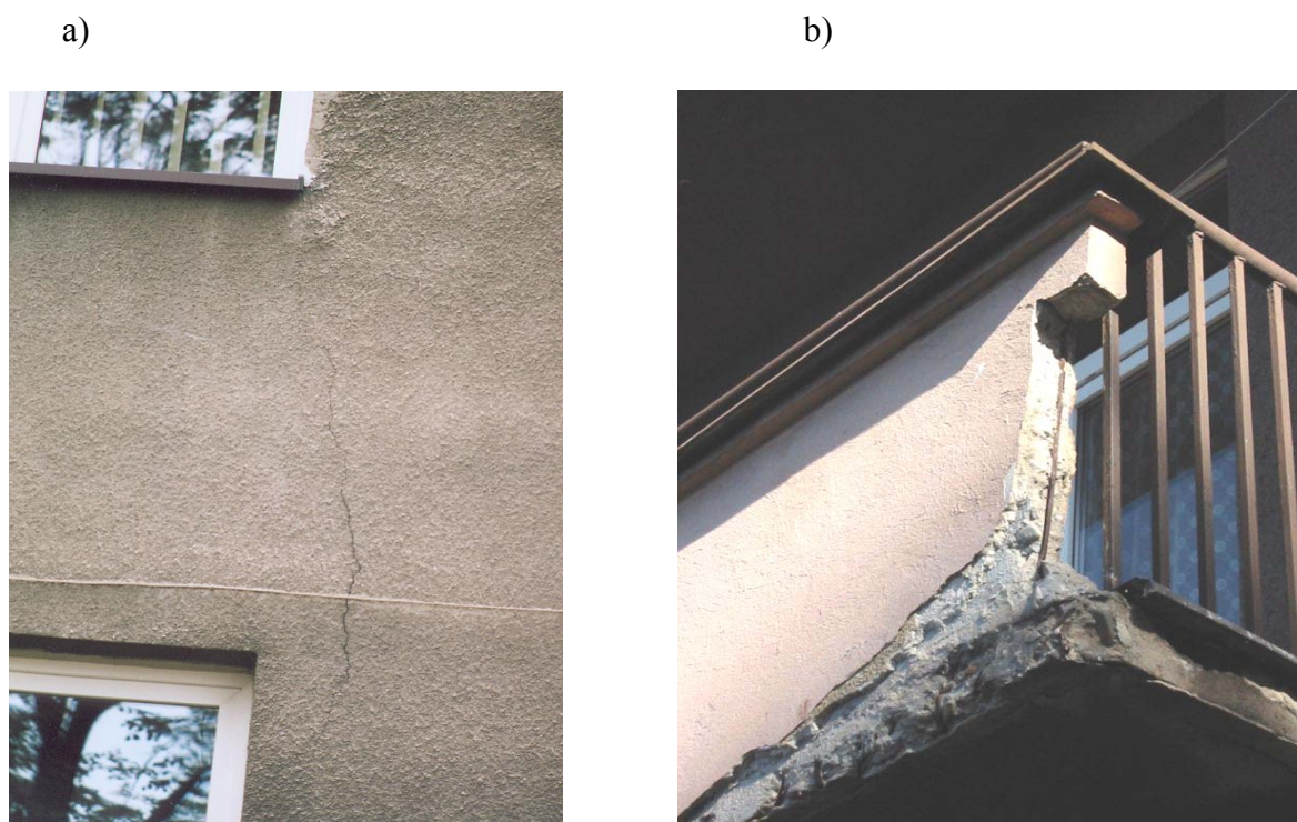
Rys. 6. Przykłady uszkodzeń budynku: a) zarysowanie ściany na skutek osiadania budynku, b) zniszczenie narożnika balkonu (odkryte zbrojenie) spowodowane brakiem właściwej obróbki blacharskiej i destrukcyjnym działaniem czynników atmosferycznych [fot. własna]
