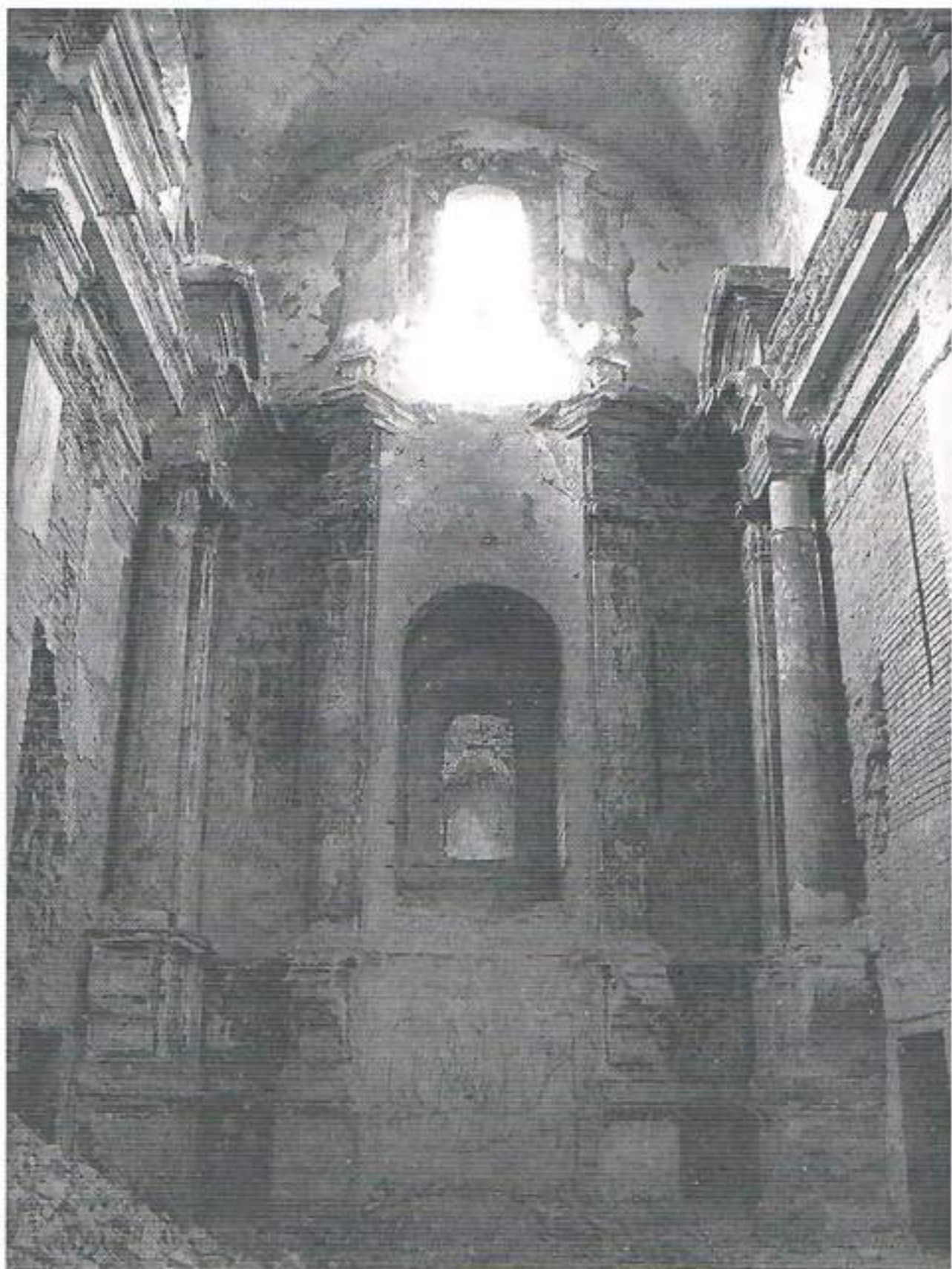
Beresteczko – zniszczone w czasach sowieckich wnętrze zabytkowego kościoła rzymskokatolickiego pw. Św. Trójcy (fot. Agnieszka Stachnik).
