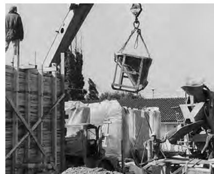
10.5-9 PODAWANIE DO DESKOWANIA MIESZANKI GLINIANEJ Z DODATKAMI MINERALNYMI PRZY BUDOWIE DWUKONDYGNACYJNEJ ŚCIANY NOŚNEJ W TATA, WĘGRY
