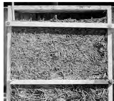
3.7-1 SZCZELINA SPOWODOWANA OSIADANIEM LEKKIEJ GLINY ZE SŁOMĄ W KONSTRUKCJI DREWNIANEJ
