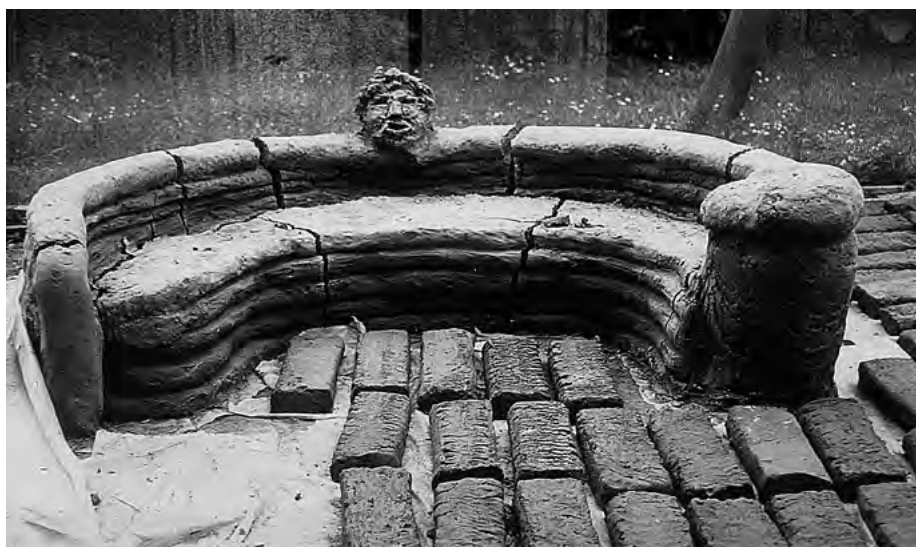
8.1-2 PĘKNIĘCIA SKURCZOWE PO WYSCHNIĘCIU GLINY
