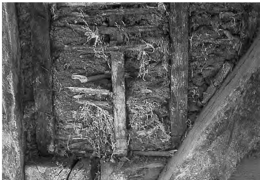
10.4-1 ZNISZCZONA PRZEZ GRZYBY PLECIONKA W ŚCIANIE
