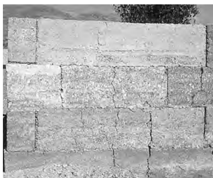
5.4-1 PĘKNIĘCIA SKURCZOWE GLINOBITKI, EKWADOR
